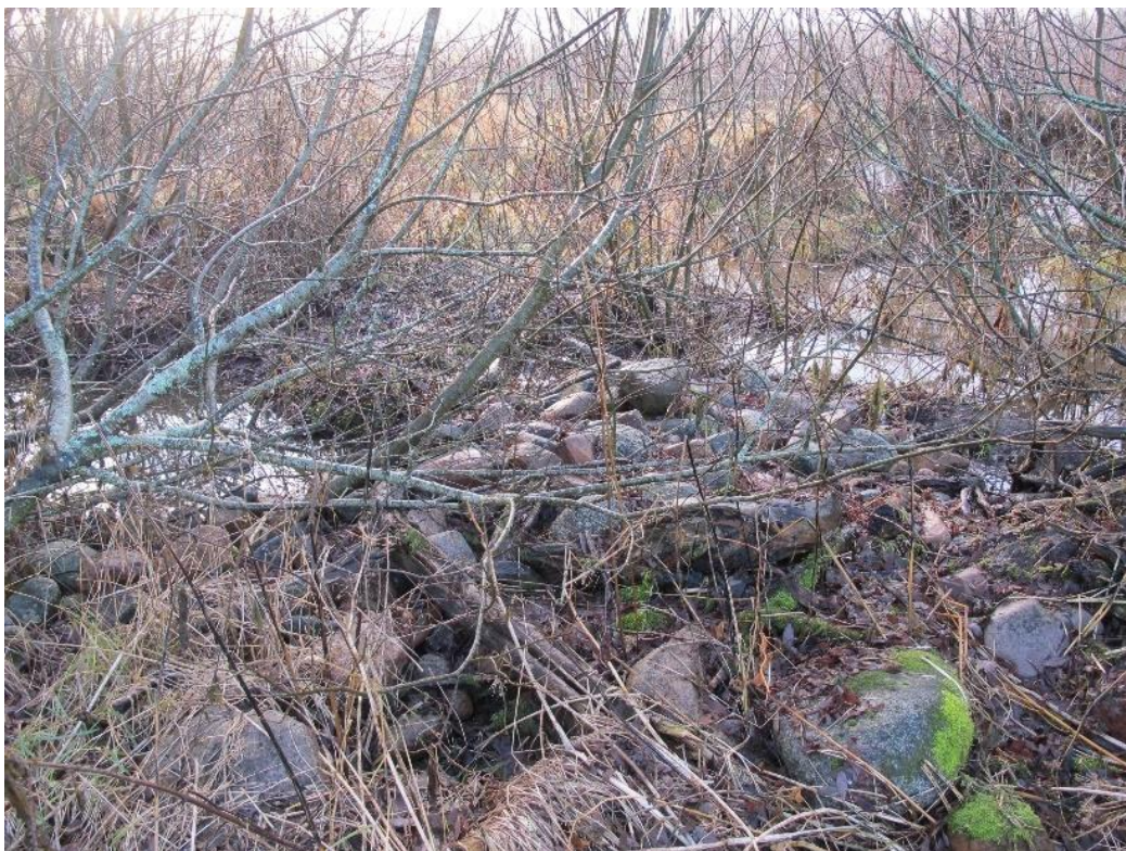
Bild 7. Stendammen som anlagts mellan Finnbackaträsket och diket bör rivas.
